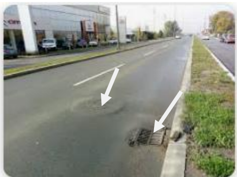
Rrjeti i kanalizimit në rrugën qarkulluese [3]
