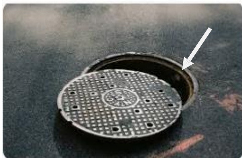
Kapak i rrjetit të kanalizimit në rrugën qarkulluese [3]
