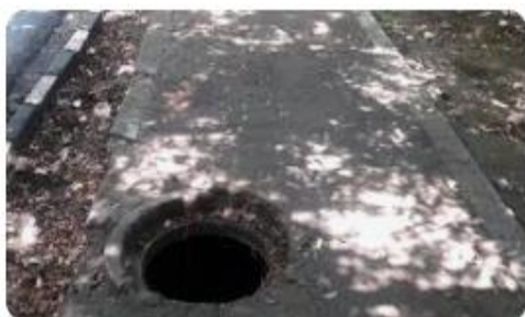
Kanalizaciona mreža bez poklopca u saobraćajnom putu [3]
