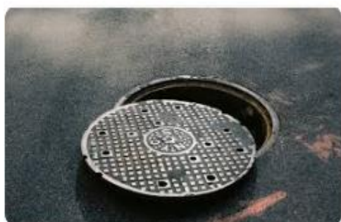
Poklopac kanalizacione mreže u saobraćajnom putu [3]
